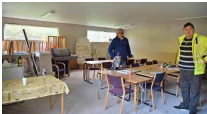
Mycket är redan klart i klubbstugan, men det fattas klinkers på golvet och vävtapeter på väggarna. Huset kommer att ha två toaletter och ett fint kök samt kontor, förråd och stort samlingsrum.
